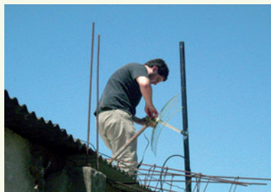
INSTALLATION D'UNE ANTENNE DANS LE QUARTIER TOBA. PHOTO: NODO TAU
